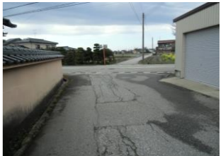
⑧飯沢地内の道路 狭く、見通しが悪い。
